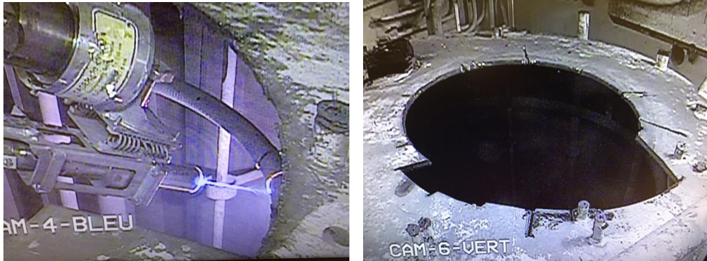
Découpe du sommet d'une cuve de dissolution, par MAESTRO équipé d'une tête laser. © CEA/DR
