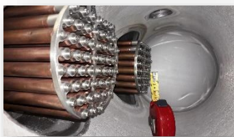
Figure 1 : Vue intérieure de l'échangeur de chaleur avec faisceaux de tubes de cuivre.
